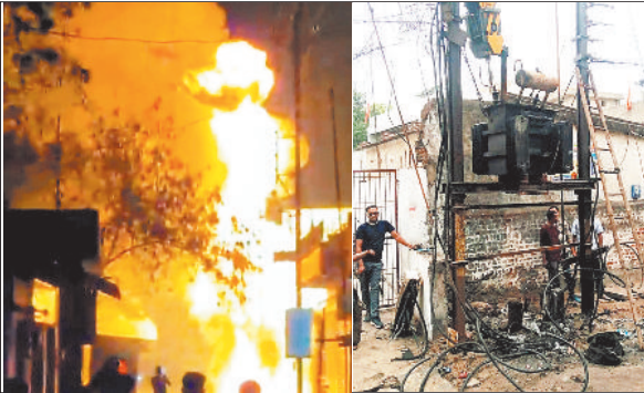
जलता ट्रांसफार्मर एवं मरम्मत कार्य में जुटा मंडल का अमला ।
